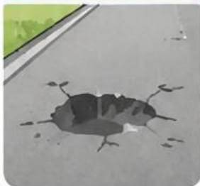
道路の穴ぼこ・段差
