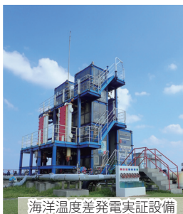
海洋温度差発電実証設備
