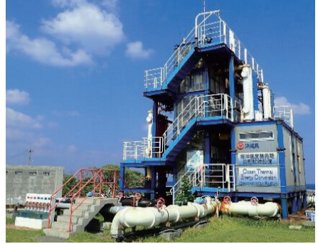
▼ 写真：海洋温度差発電（OTEC）実証設備
