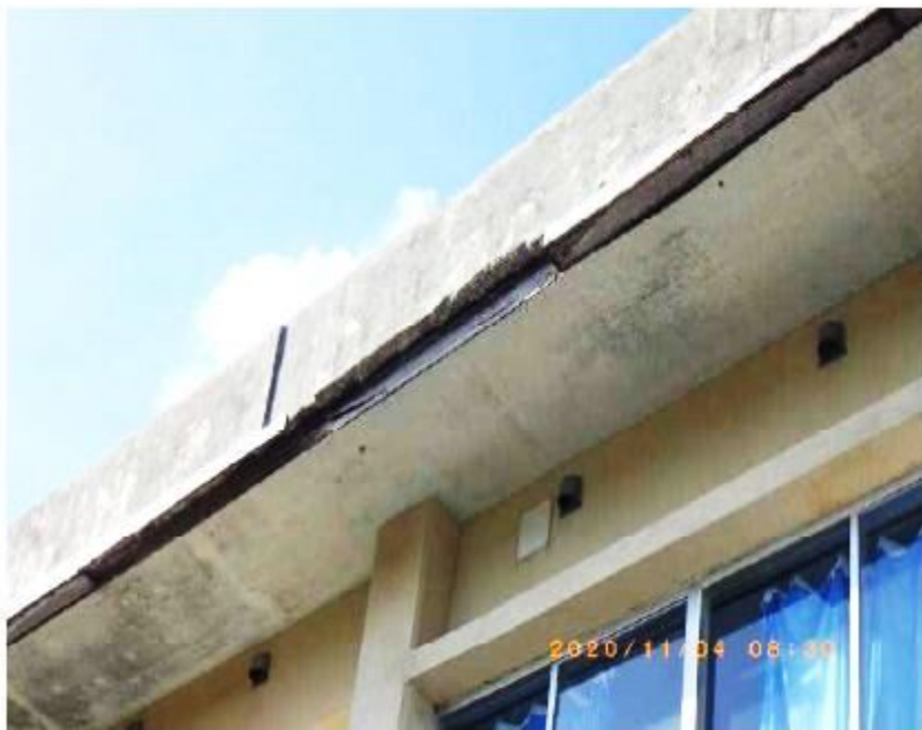
〈コンクリートの剥離〉
