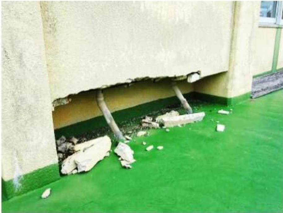
〈コンクリートの剥離〉
