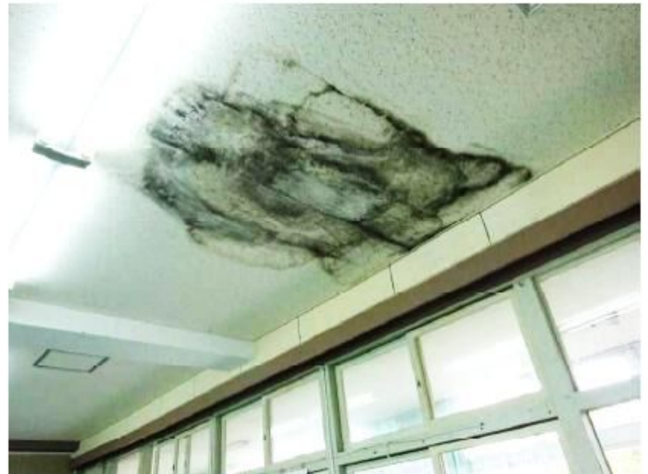
〈雨漏りで天井板にカビが発生〉
