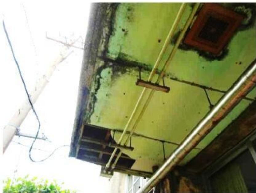
〈天井板の劣化〉
