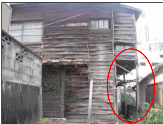
柱の数箇所に破損がある例
