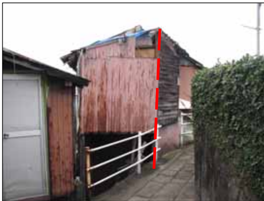
一部の柱が傾斜している例
