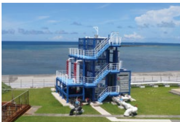
海洋温度差発電施設
