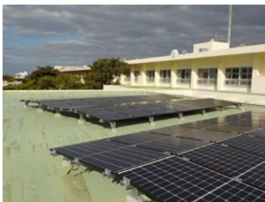
太陽光発電（球美中学校校舎屋上）
