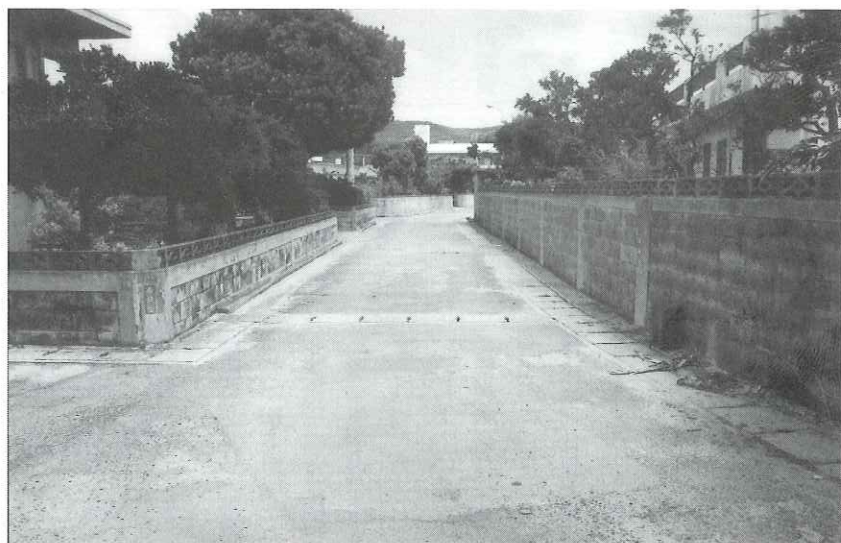
老朽化した儀間12号線(志良堂蔵より)
