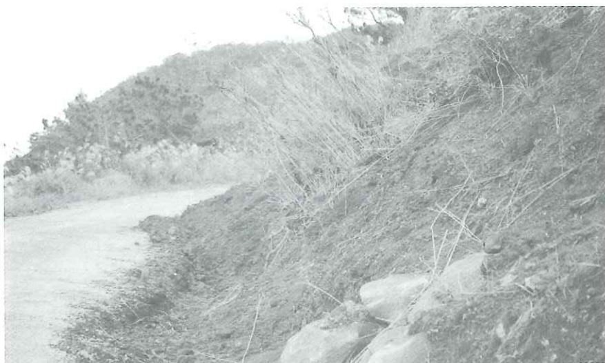
山田原農道の土砂崩落現場
