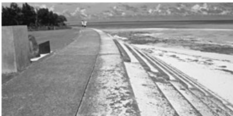
畳石側面の階段式護岸へ安全策での手すり設置を
