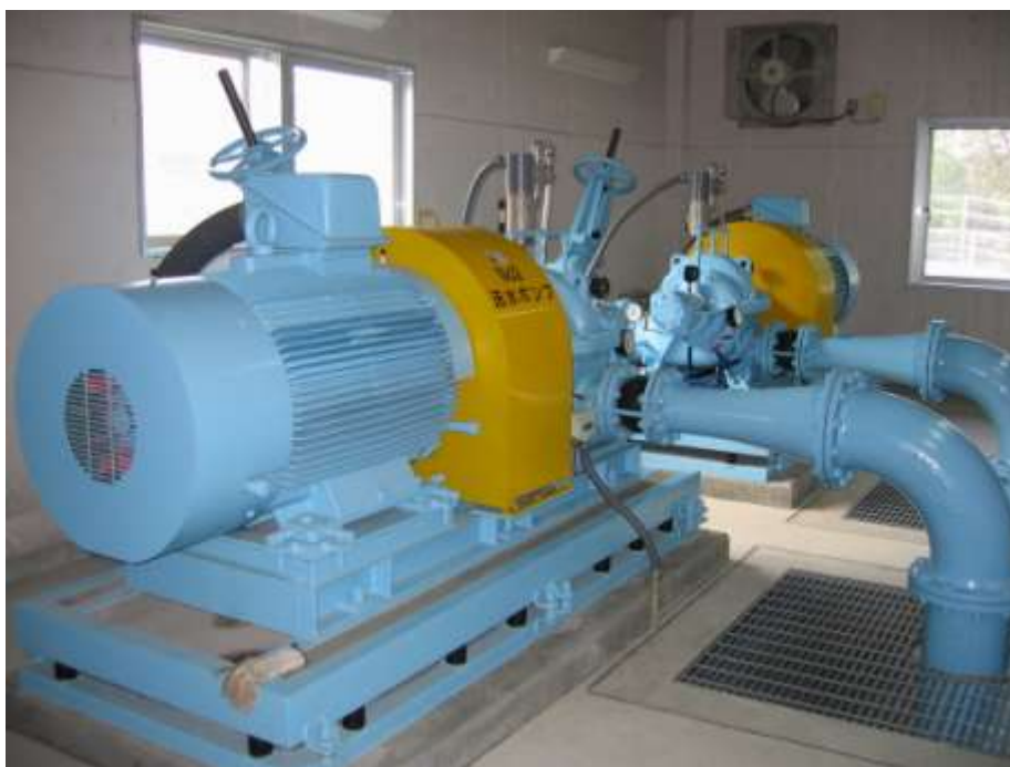
施設された2台の揚水ポンプ (150 kW × 2)
