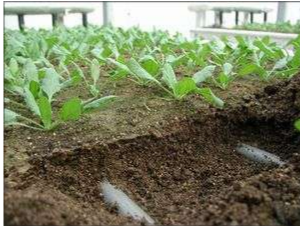
図 4-21 地中に埋設されている塩ビ管 (12℃の冷水が流れている) 提供：沖縄県海洋深層水研究所
