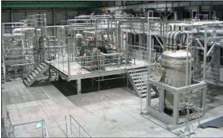
図 4-9 佐賀大学海洋エネルギー研究センター内 30kW 海洋温度差発電実験設備
