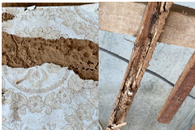
天井材や下地にもシロアリ被害
