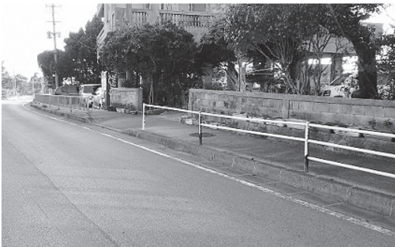
早急な改修が求められるガードレール
