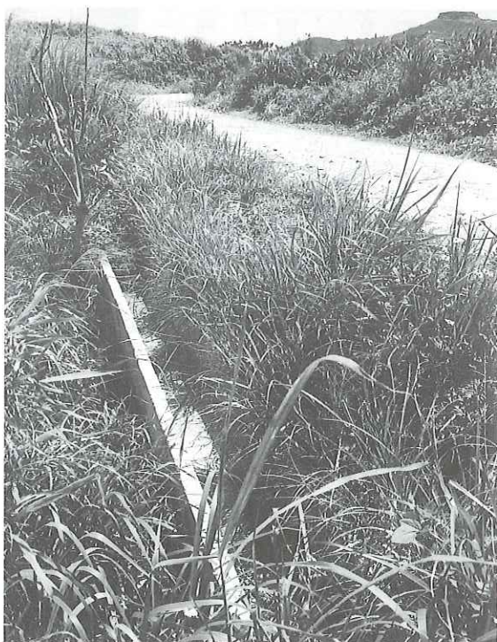
側溝が宙に浮いている農道
