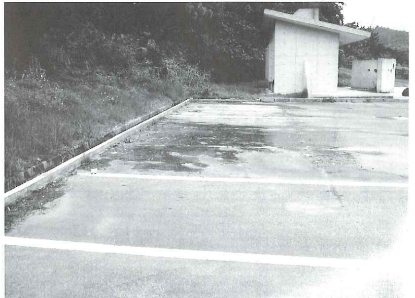
湧き水が染み出た白瀬川駐車場
